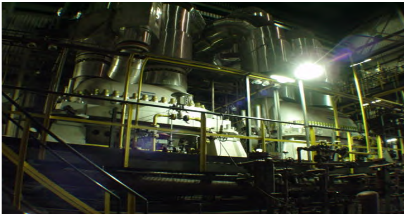
Compressore centrifugo gas siderurgici - CET3
