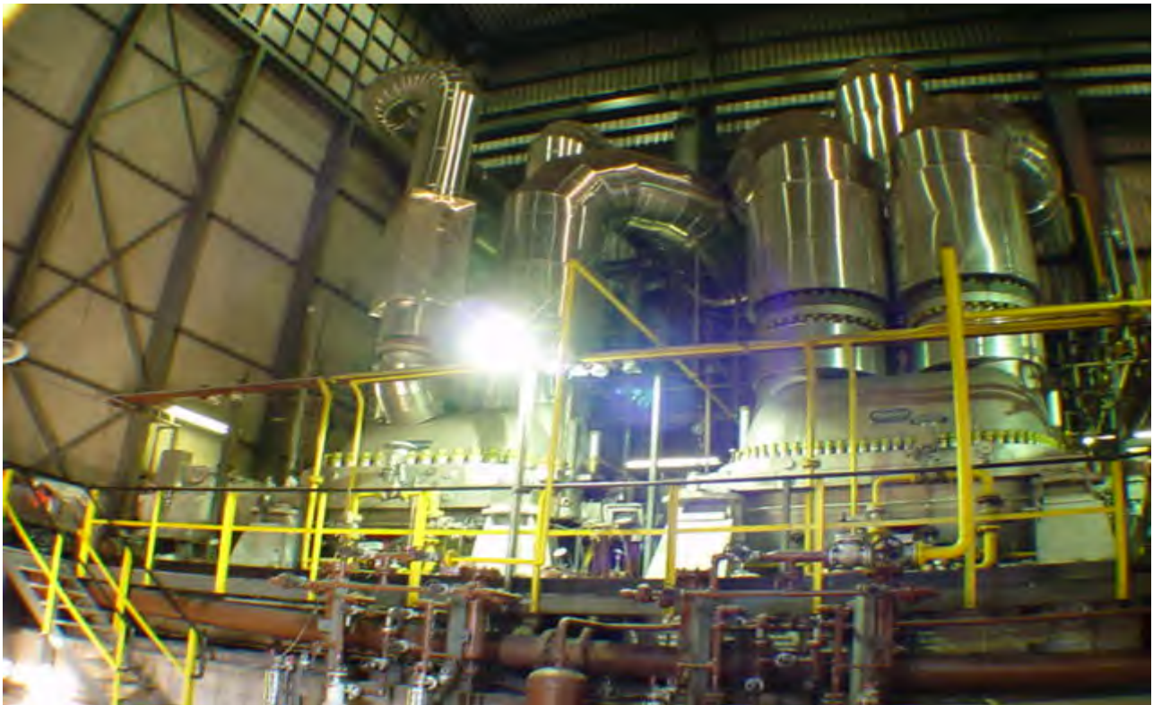
Compressore centrifugo gas siderurgici - CET3
