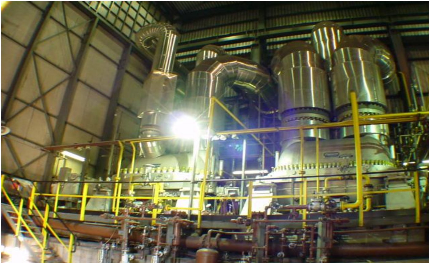
Compressore centrifugo gas siderurgici - CET3
