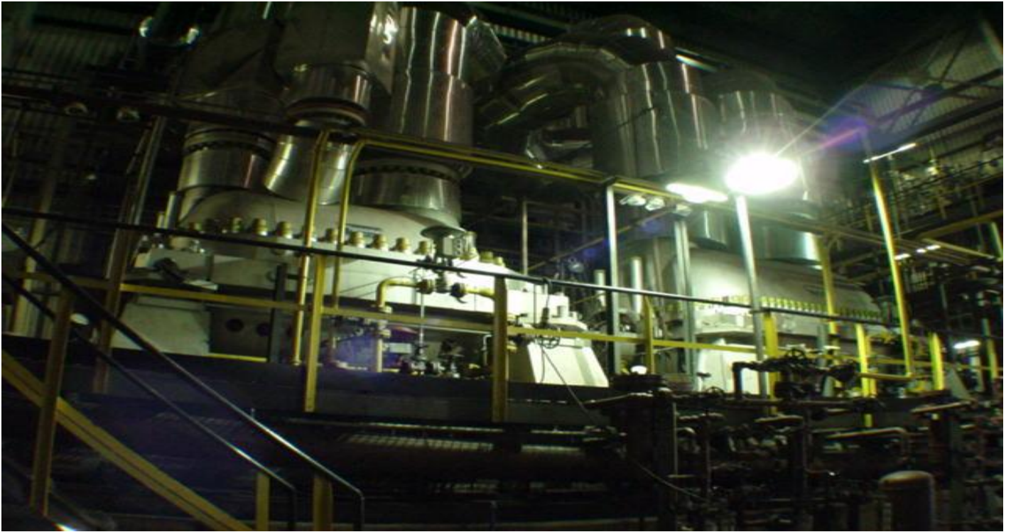
Compressore centrifugo gas siderurgici - CET3
